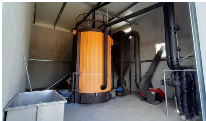
Figura 3.4.2. Caldeira existente na instalação, semelhante à que será instalada.
