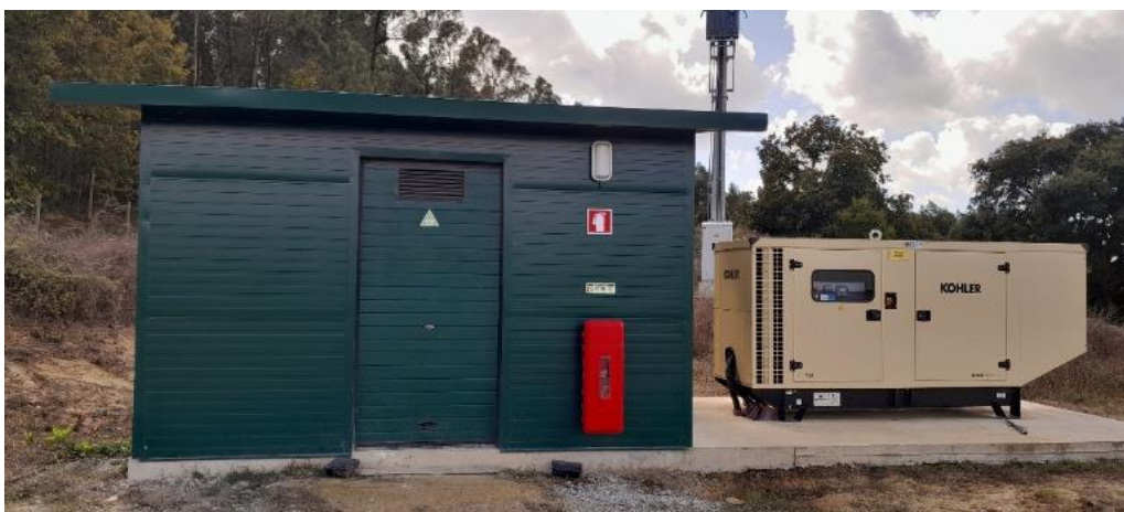
Figura 3.1.10. Posto de transformação (PT) e gerador de emergência (GE) existentes (22).
